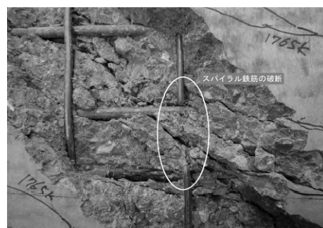
(b) 鉄筋破断箇所
