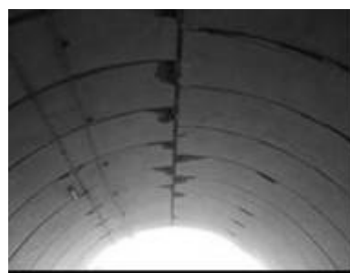
(a) 頂部ヒンジ部の損傷
