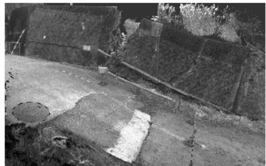
図5. 変状域の部分的な詳細地形モデルの例
