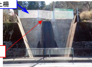
図 13 土砂流出防止柵 設置状況（再掲）
