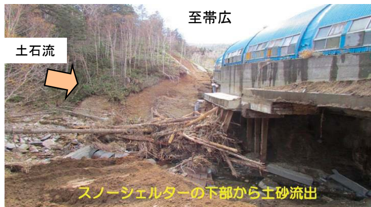
図4 三国の沢シェルターのカルバート流入口の被災状況 d)に加筆
