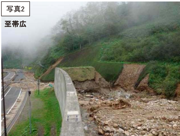
図3 終点側溪流の流出防止用盛土の侵食崩壊状況 a) に加筆
