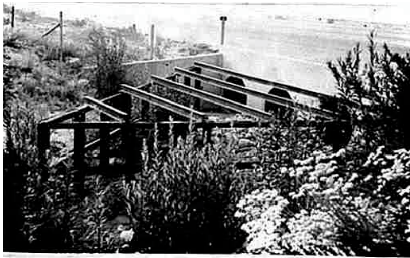
図 2-2 三連のカルバート流入口の手前に設置された鉄レール製の Deflector (平常時) 2)
