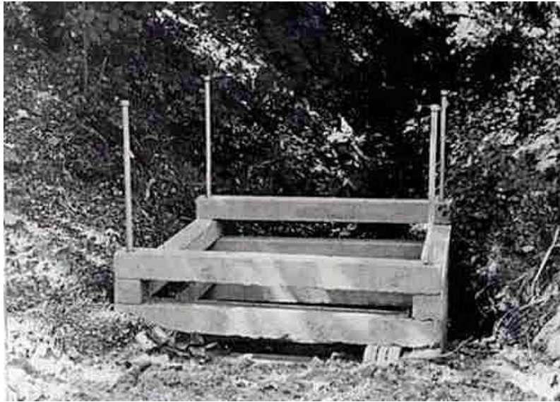
図2-10 プレキャストコンクリート部材と鉄筋によるダボで作られた Crib (流入口の取り付けますを覆うように設置) 2)
