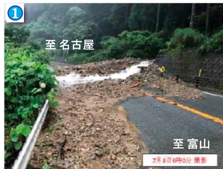
図3 道路被害状況 (図2の①から撮影)
