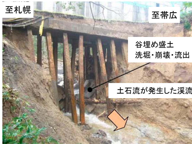
図3 三国の沢シェルターの洗掘状況(下流より撮影) c)に加筆
