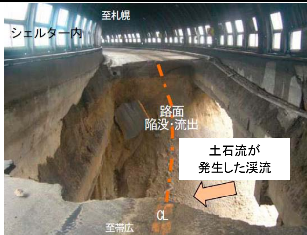
図2 三国の沢シェルターの路面陥没・流出状況(終点側から起点側を撮影) c)に加筆
