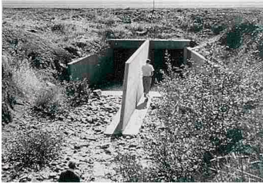
図2-12 二連のボックスカルバートの中央壁を延長する形式で設置されたコンクリート製のFin 2)
