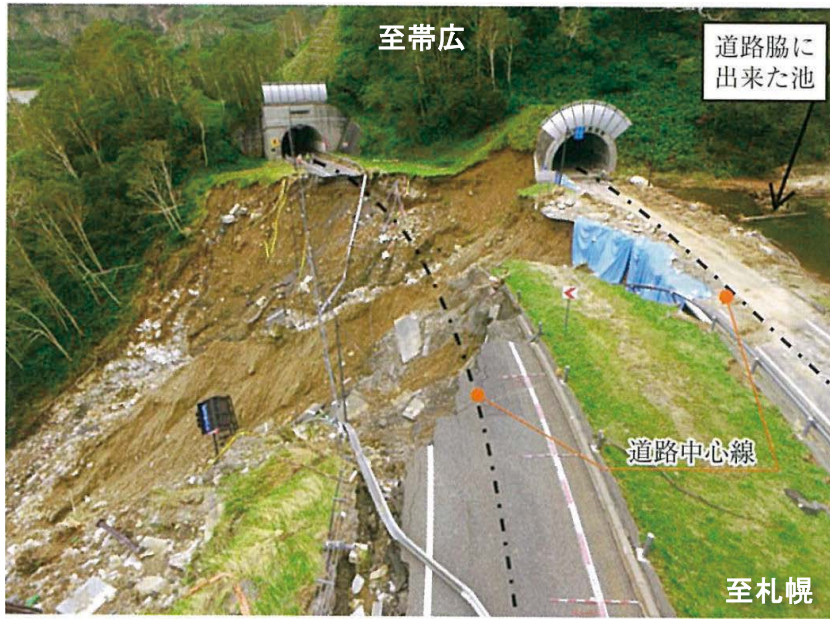
図4 道路の被害状況(トンネル入口付近拡大) c)
