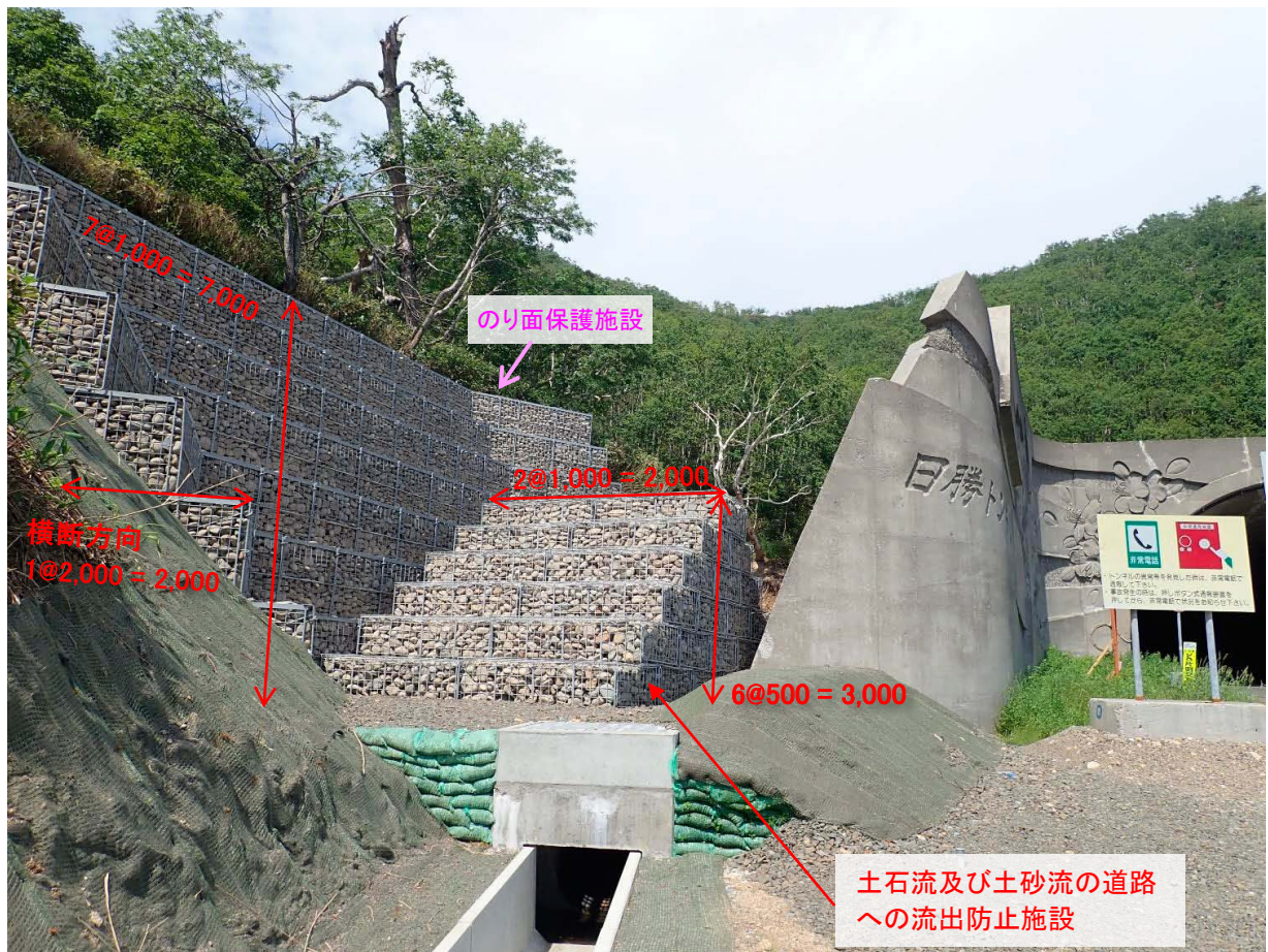
図12 土石流及び土砂流の道路への流出防止施設の状況
