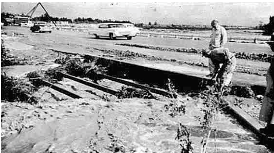
図 2-3 図 2-2 の Deflector が洪水時に機能を発揮している様子 2)
