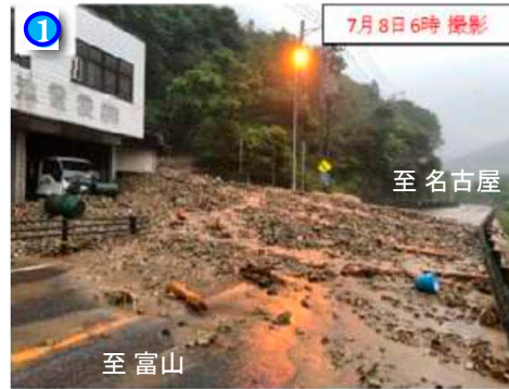
図3 道路被害状況(図2の①から撮影)
