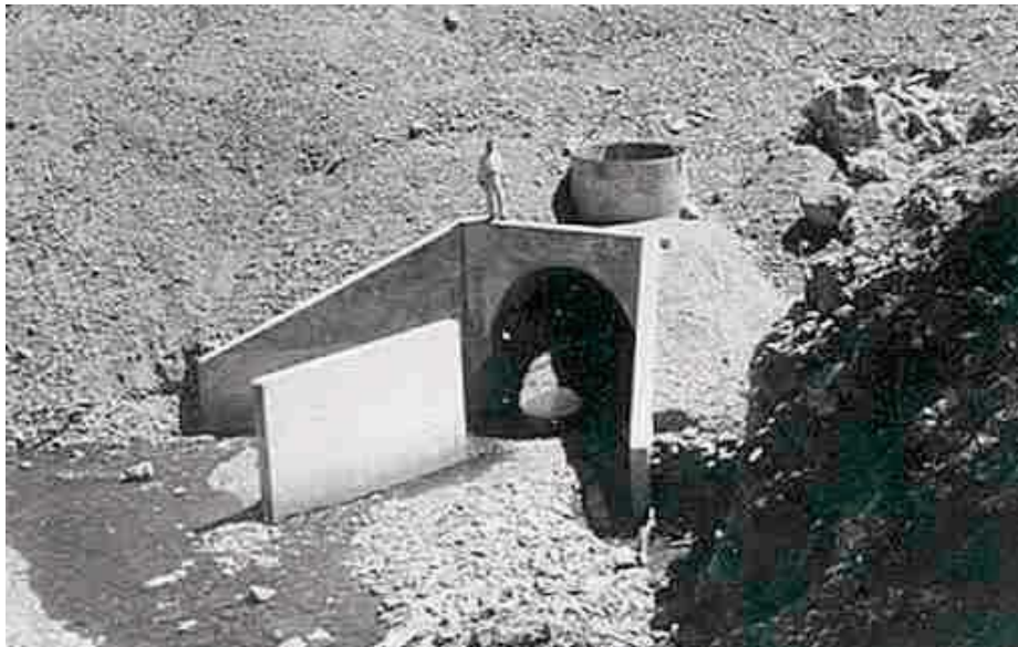
図2-13 コンクリート製のFinとコルゲートメタルパイプカルバート（直径約3 m）が設置され、複合的な対策が施されたカルバート 2)
