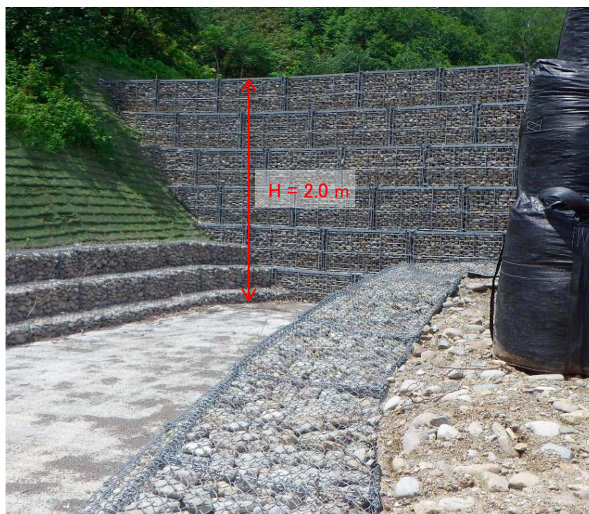
図5 土石流及び土砂流の道路への流出防止施設の状況
