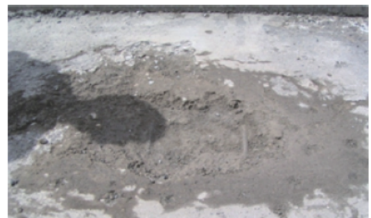
写真-1 コンクリート床版の土砂化
