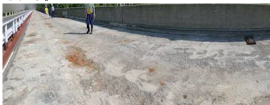
写真1 舗装開削後に土砂化が判明した事例
