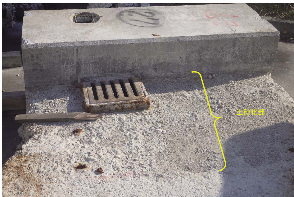
(a) パネル No. 17 の地覆付近 1)
