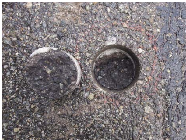
②施工打継目部（浸水あり）
