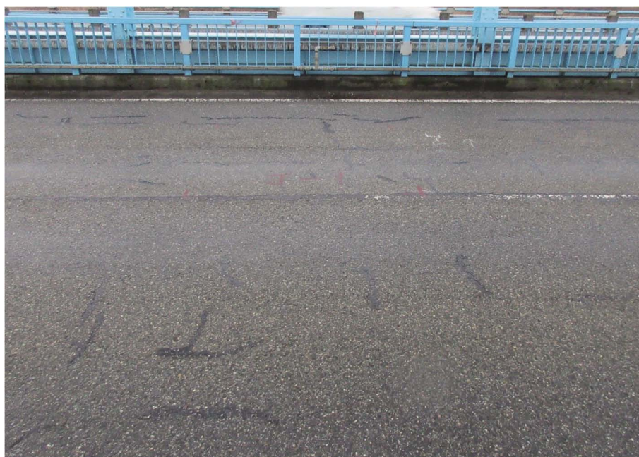
写真-3.4 D橋の路面損傷状況
