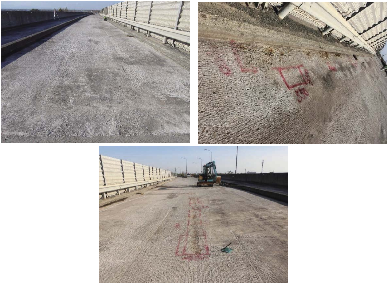
写真-3.11 F橋の床版上面の損傷状況
