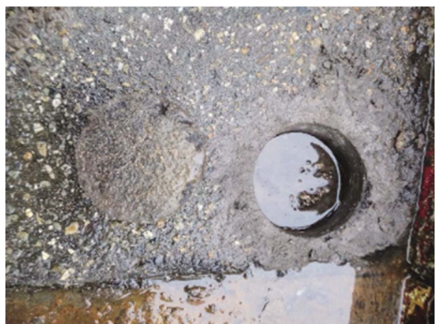
⑮伸縮装置近傍（浸水あり）
