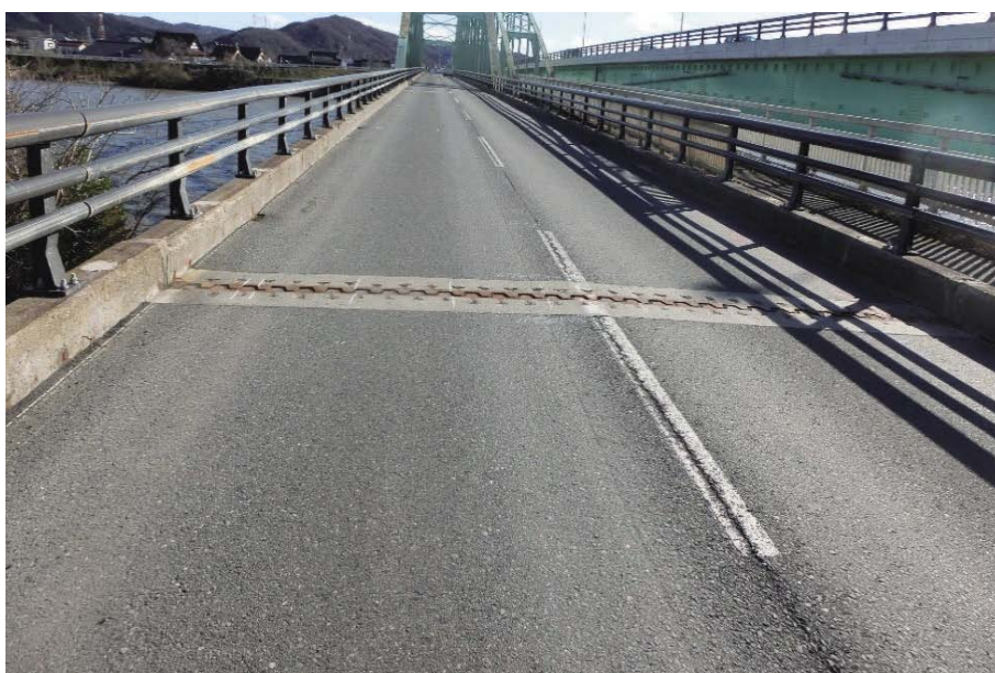
写真-3.16 I橋の路面損傷状況
