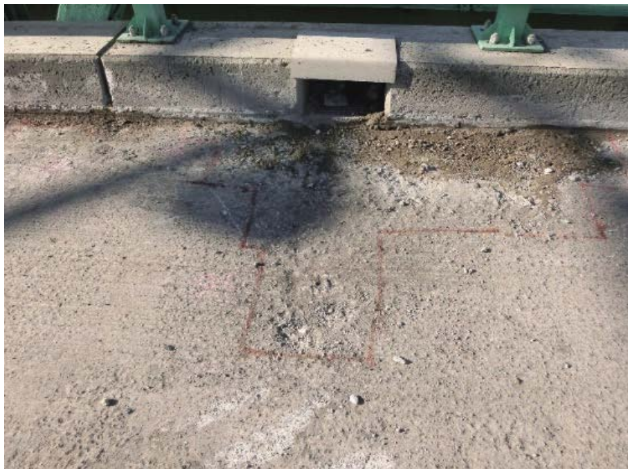
写真-3.13 G橋の床版上面損傷状況
