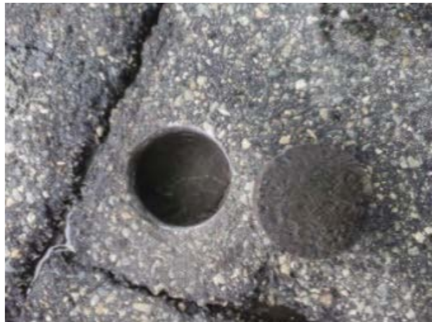
③施工打継目（浸水あり）
