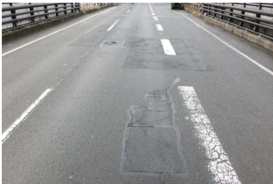
写真-3.14 H 橋の路面損傷状況
