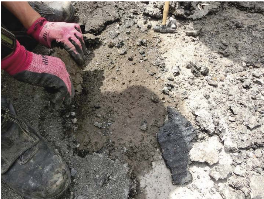
(b) 床版防水層の剥離
