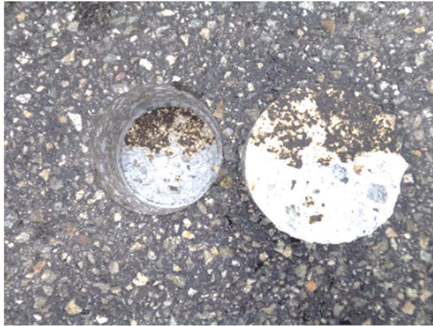
②非車輪走行部（浸水なし）
