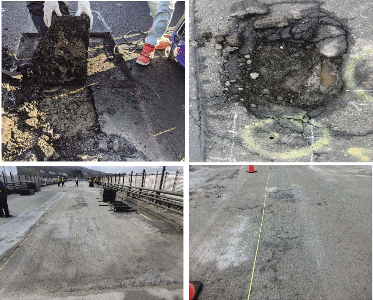
写真- 3.15 H 橋の床版上面の損傷状況
