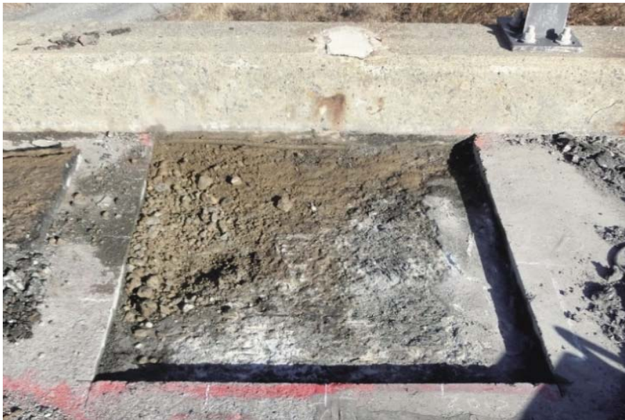
写真-3.17 I橋の床版上面損傷状況
