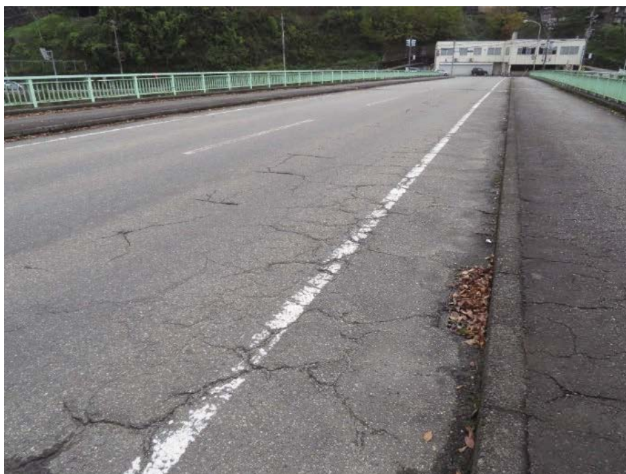
写真-3.7 E橋の路面損傷状況
