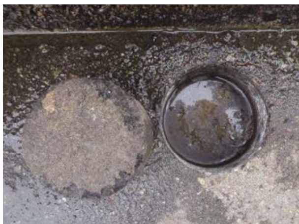
①歩道側端部部（浸水あり）
