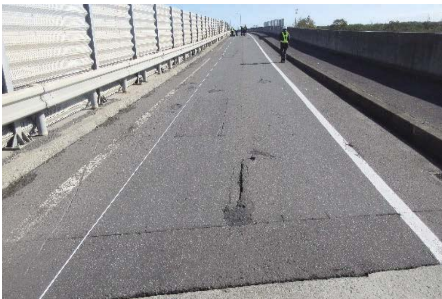
写真-3.10 F 橋の路面損傷状況
