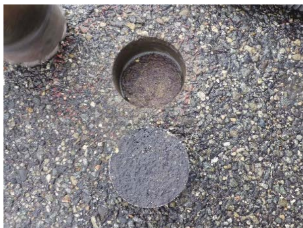
⑥非車輪通行部（浸水なし）
