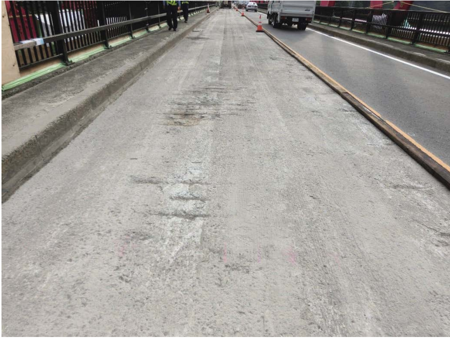
(a) 床板土砂化
