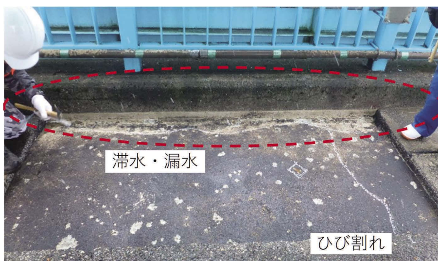
写真-3.6 D橋の床版上面損傷状況
