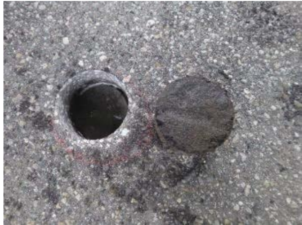
⑨非車輪通行部（ひび割れ近傍）（浸水なし）
