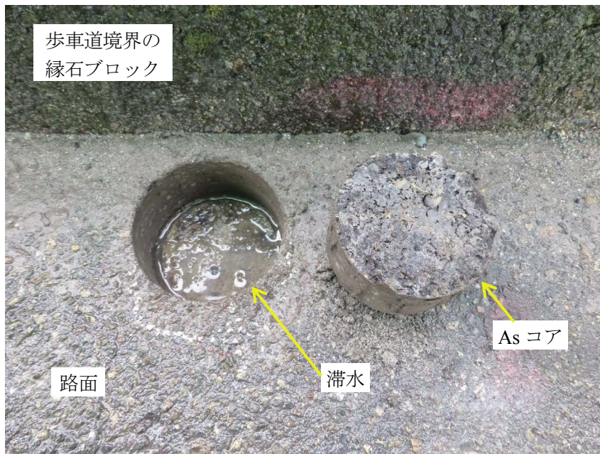
図-7.4 目地部付近の橋面 As舗装下の滞水
