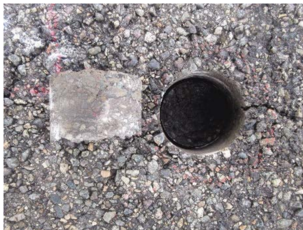
③ひび割れ直上部（浸水なし）
