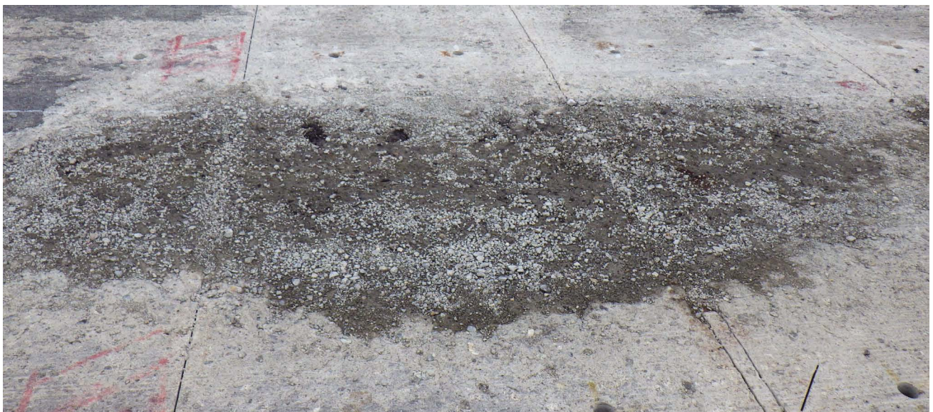
(b) 土砂化部の拡大，ただし撮影方向は横向き（図(a)の赤矢印方向に撮影）
