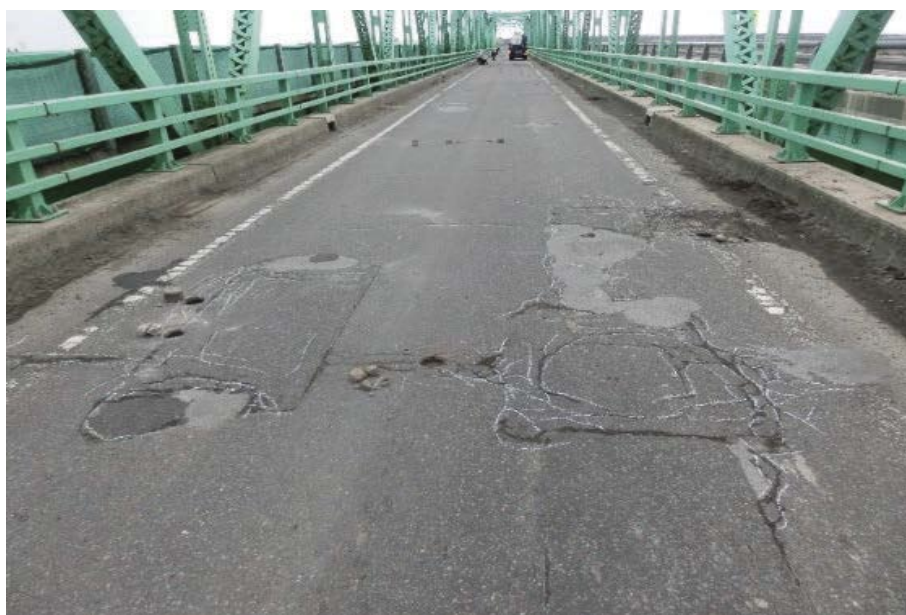
写真-3.12 G 橋の路面損傷状況
