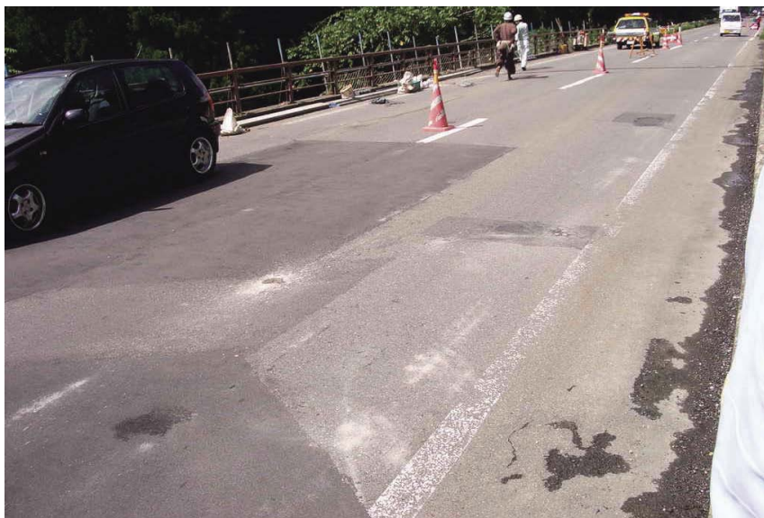
図-7.7 部分補修による橋面舗装のパッチワーク状態の事例
