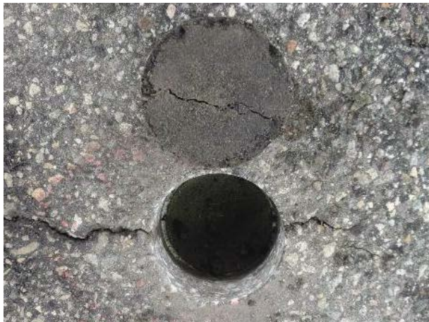
⑧ひび割れ直上部（浸水あり）
