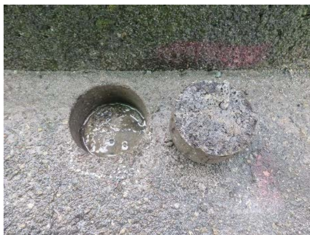
④地覆側端部（浸水あり）
