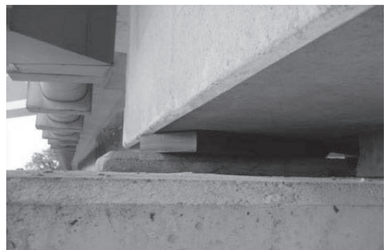
写真-2 パッド型ゴム支承の沓座よりの逸脱
